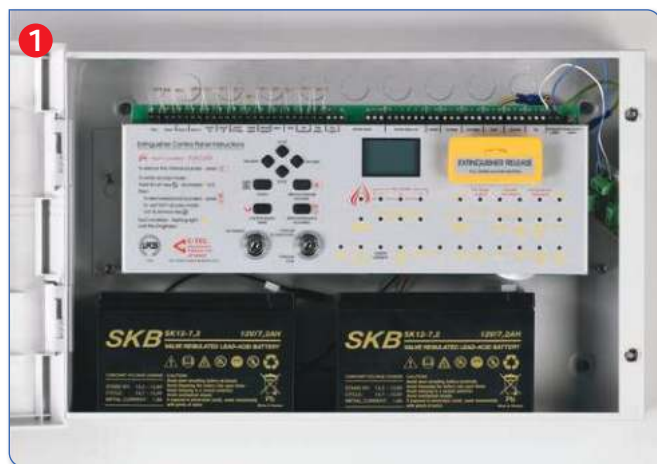
Centrale di spegnimento automatica
