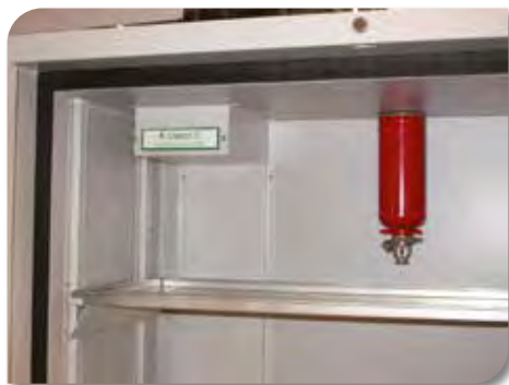
Apparecchio estintore Installato in un armadio di sicurezza
