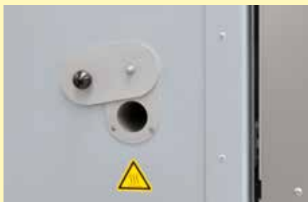
Passaggio per termocoppia
